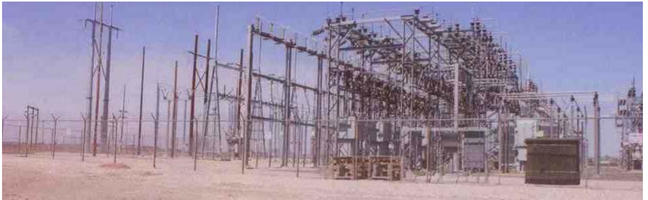
Часть промежуточной подстанции 115/34.5/110 кВ, соответствующая однолинейной схеме
