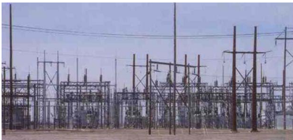
Часть промежуточной подстанции 115/34.5/110 кВ к которой ветряные фермы подключаются через линию 34.5 кВ
